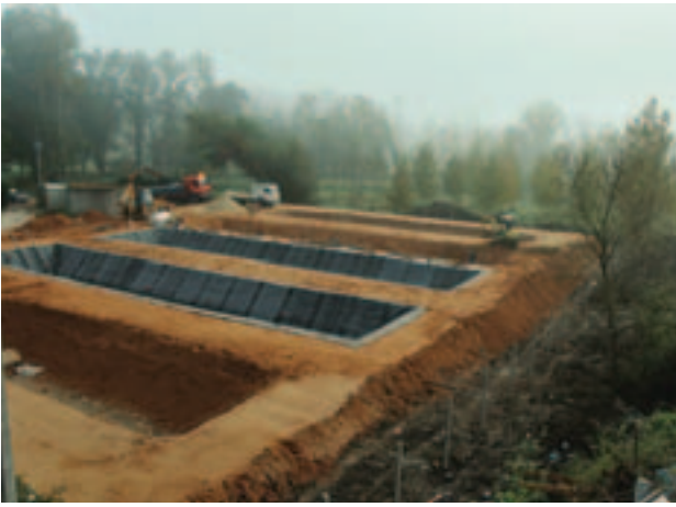
Vasche di fitodepurazione
